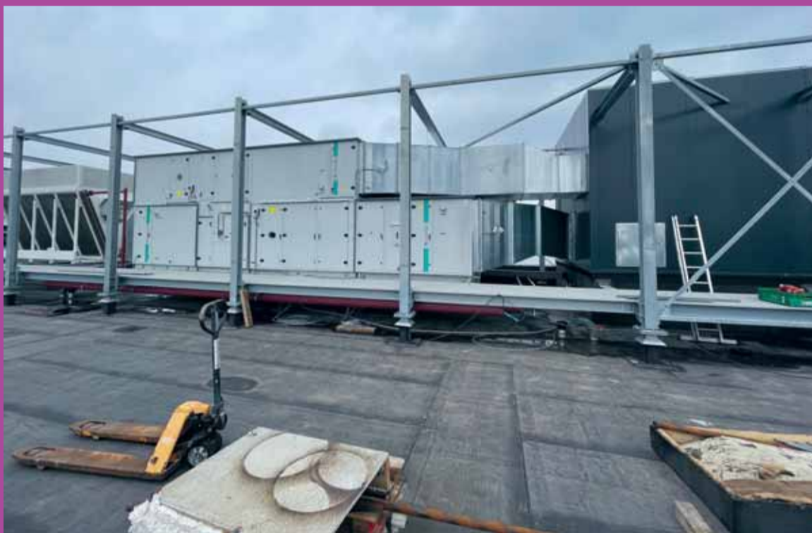
Op het dak van de nieuwbouw is een techniekstrook gemaakt, waarin de liftuitloop, drie grote luchtbehandelingskasten, de dry-cooler en aansluitingen naar de schachten zijn gepositioneerd.
