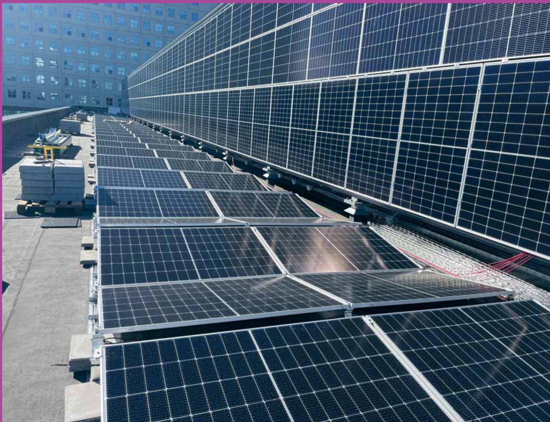
Het dak is volledig benut om zon-pv neer te leggen.
